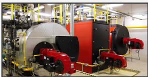
Oil- og gas boilers
